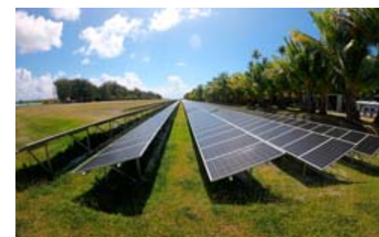
ESTHÉTIQUE Les panneaux solaires bordent la piste d'atterrissage.
